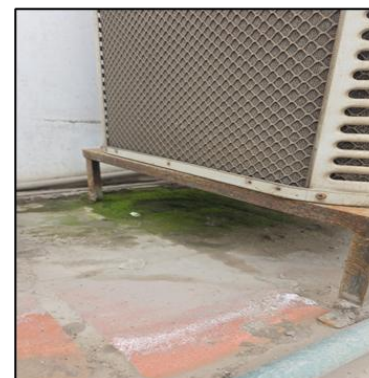
Imagen 11. Goteo de aire acondicionado- 2° piso emergencia
