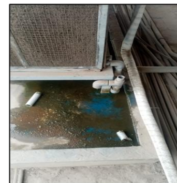
Imagen 12. Goteo de aire acondicionado- Techo de Urpa
