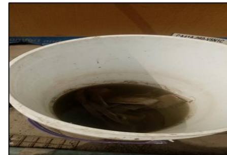
Imagen 6. Eliminación de agua acumulada- techo de Hosp. Pediatría
