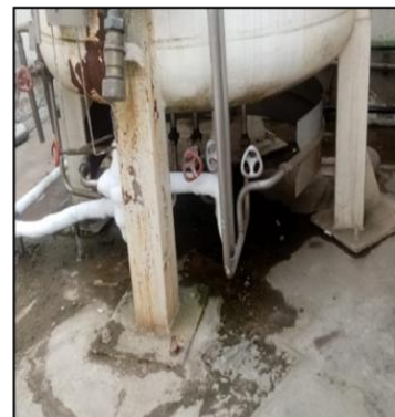
Imagen 9. Agua empozada Tanque criogénico de O 2
