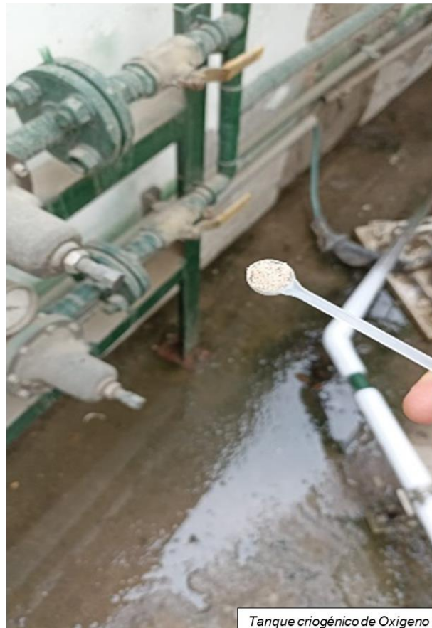
Tanque criogénico de Oxígeno
