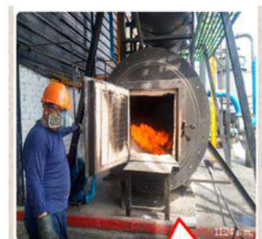
Horno de incineración de residuos
