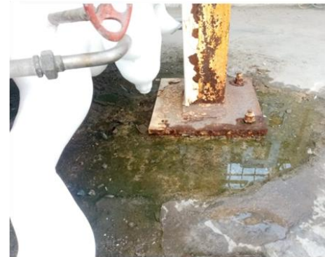
Imagen 6. Charco de agua producto del desnivel del piso
