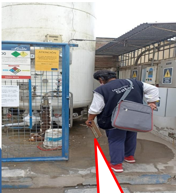
Charcos de agua en el tanque criogénico de O2
